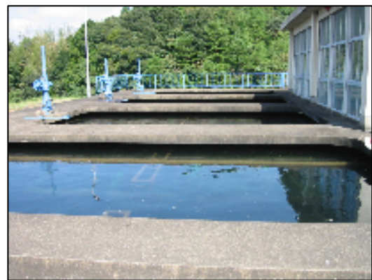
急速ろ過池（上水道）
