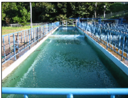
薬品沈殿池（上水道）
